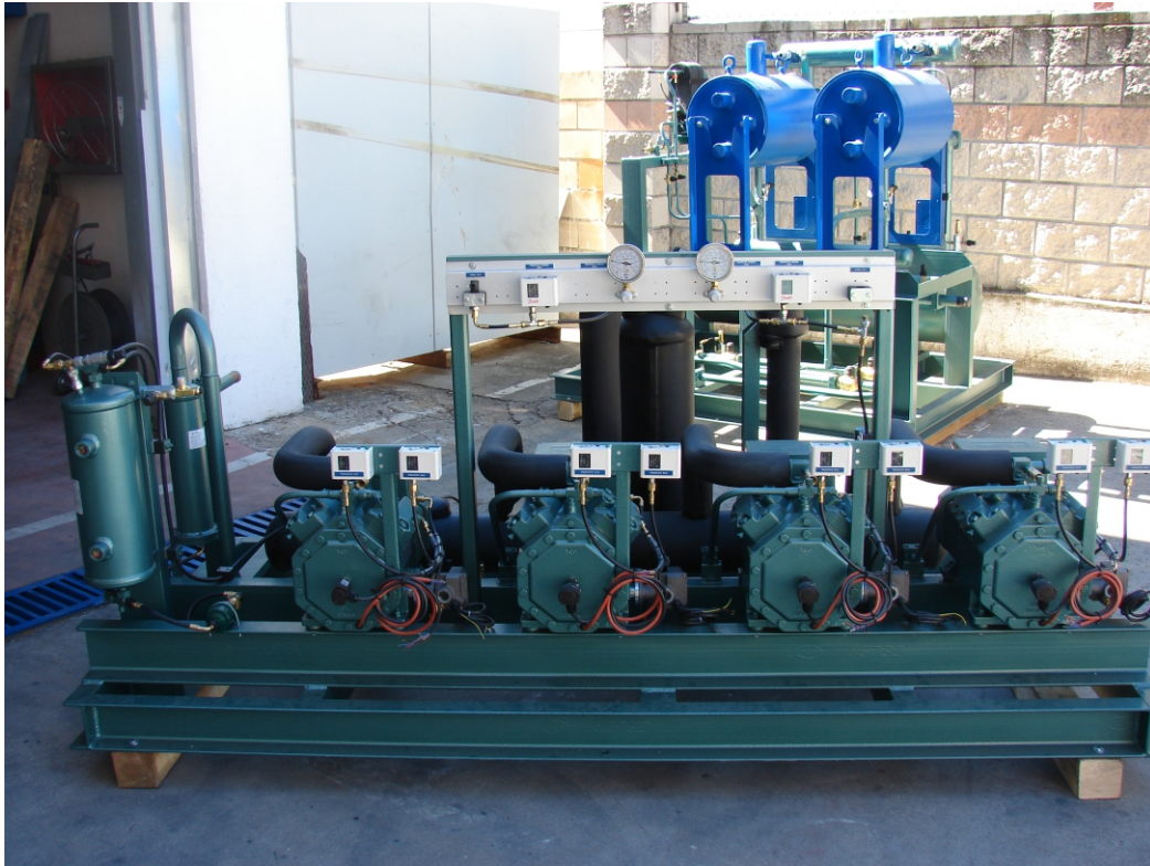
CENTRAL DE CO2 SUBCRÍTICA EN CASCADA CON AMONIACO (NH3)
