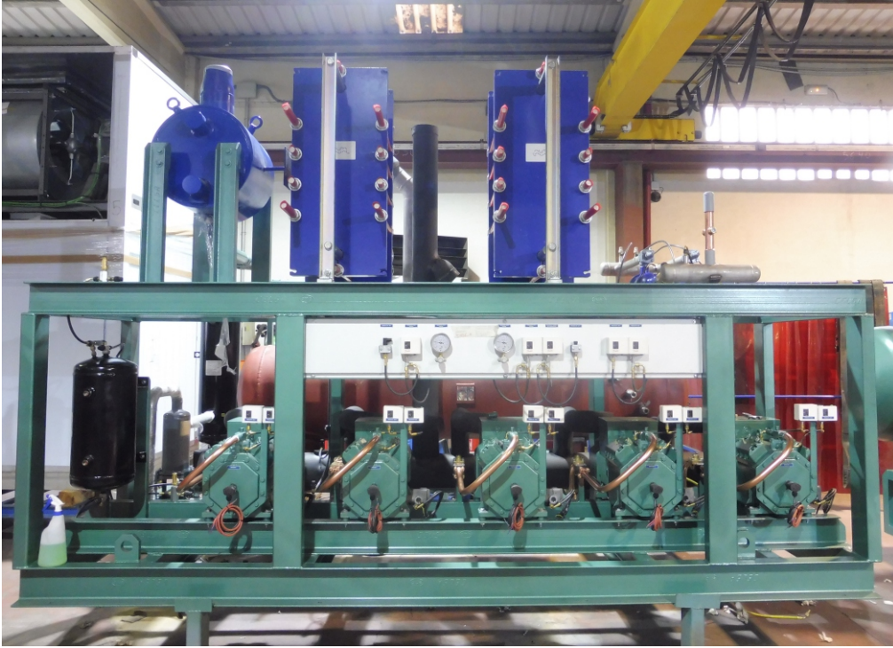
CENTRAL DE CO2 SUBCRÍTICA EN CASCADA DE CO2/ NH3 DE 5 COMPRESORES BITZER
