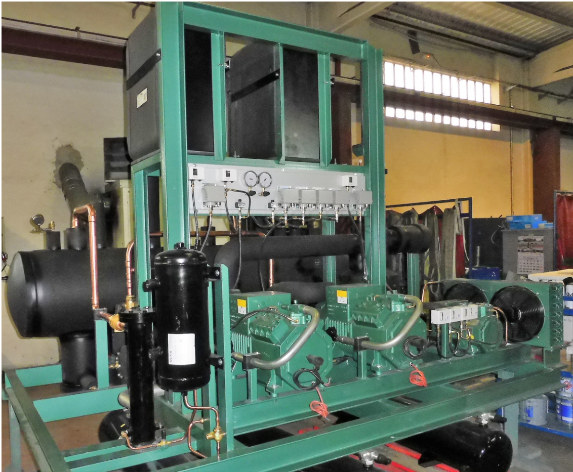
CENTRAL DE CO2 SUBCRÍTICA ENFRIADORA DE GLICOL (-40/0°C).
