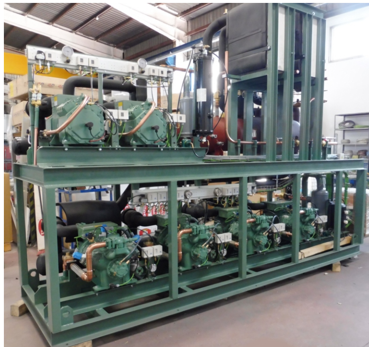
CENTRAL DE CO2 SUBCRÍTICA EN CASCADA DE CO2/ R513A
