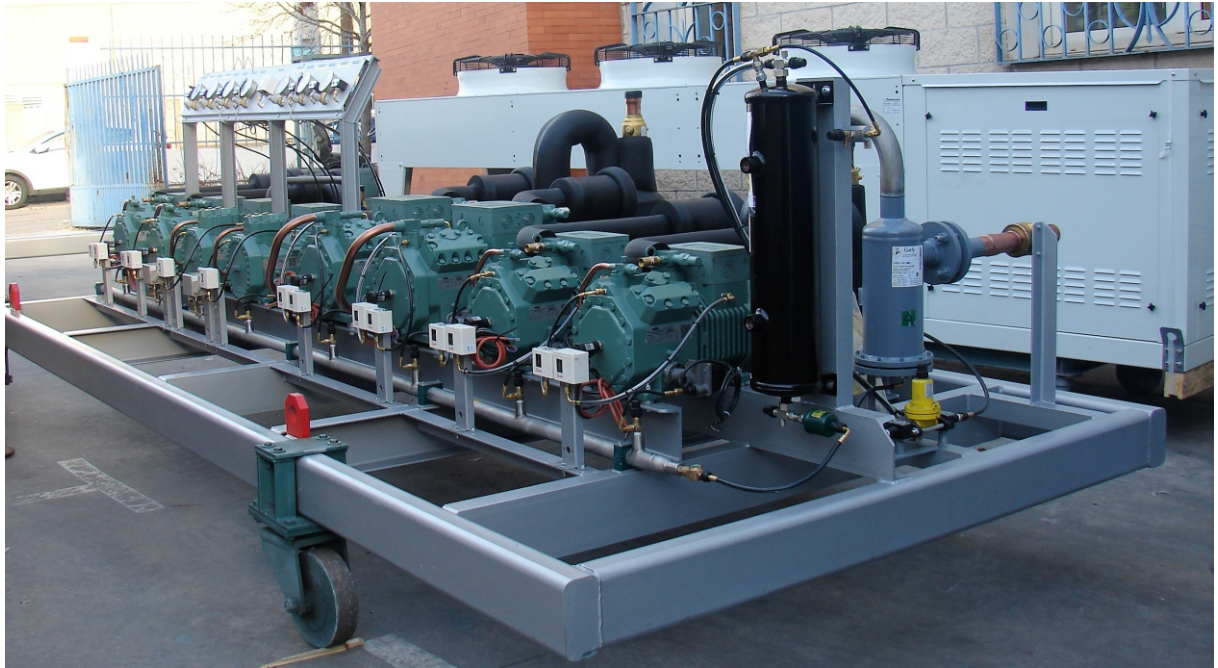
CENTRAL MULTIASPIRACIÓN DE CO 2 SUBCRÍTICA EN CASCADA CO 2 /NH 3 CON DESESCARCHE POR GAS CALIENTE RÉGIMEN (-46, -40, -28 °C)
