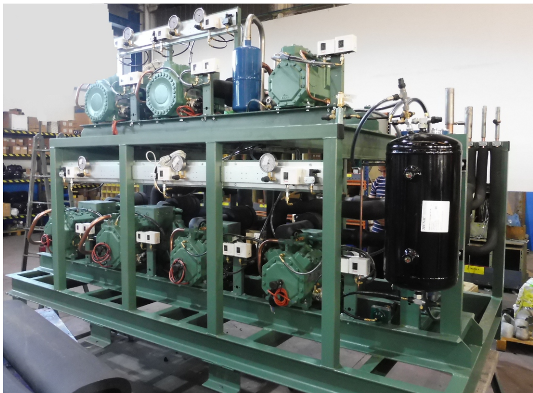
CENTRAL MULTIASPIRACIÓN DE CO 2 SUBCRÍTICO EN CASCADA CO 2 /NH 3 CON DESESCARCHE POR GAS CALIENTE Y EN DOBLE ALTURA
